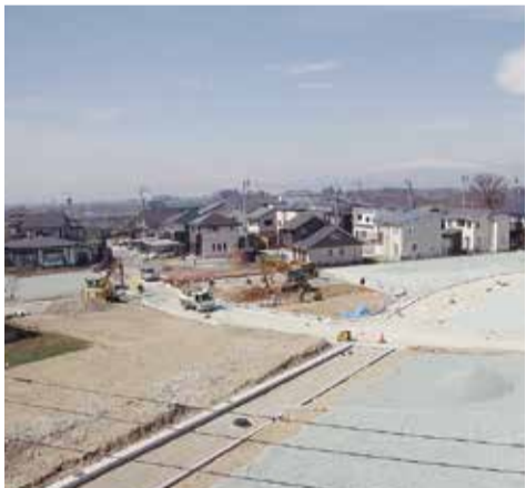
25区画の分譲が完売した「なでしこの里」で第二期造成の工事が進行=天童市山口
